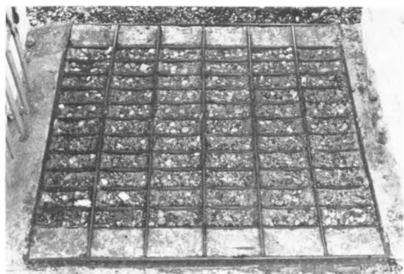
Ved Dejbjerg Kirke ligger risten i østindgangen støbt fast i cement. Den anden rist er aflignende konstruktion og anbragt på samme måde. Foto: Ulrik Schrøder.
